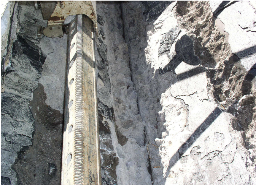
Figura 34. Diga del Poggia – binario a guida del filo
