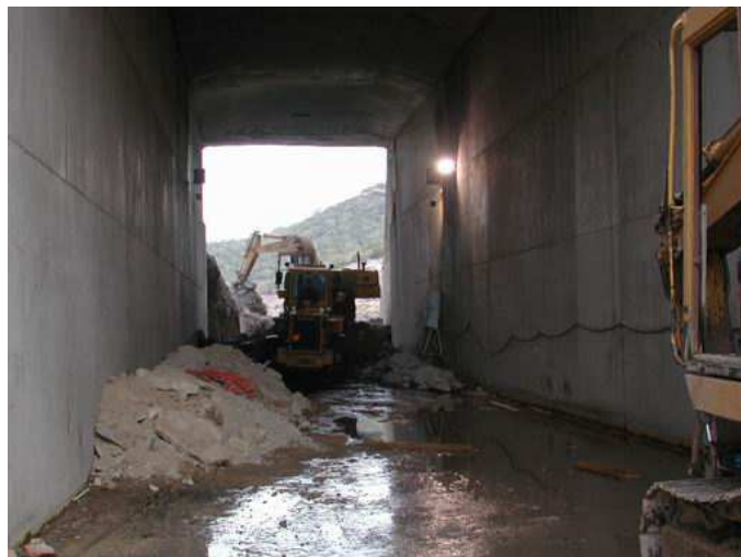
Fig. 5.4 – Fasi di completamento della struttura scatolare realizzata tra i contrafforti della diga
