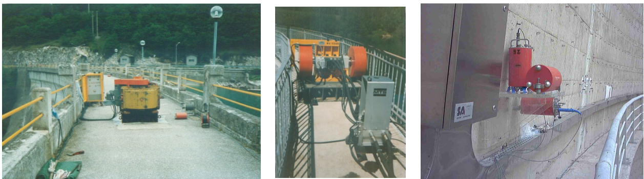
Figura 15 – Esempi di attrezzature impiegate nelle indagini dinamiche: vibrodina meccanica (a destra) e vibrodina idraulica (al centro) posizione sul coronamento diga; terna accelerometrica installata sul paramento di valle
