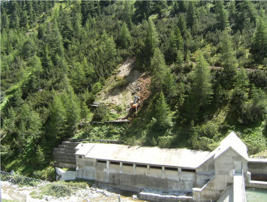
OPERA DI PRESA E DISSABBIATORI – IN SPONDA DESTRA IL VERSANTE IN FRANA
