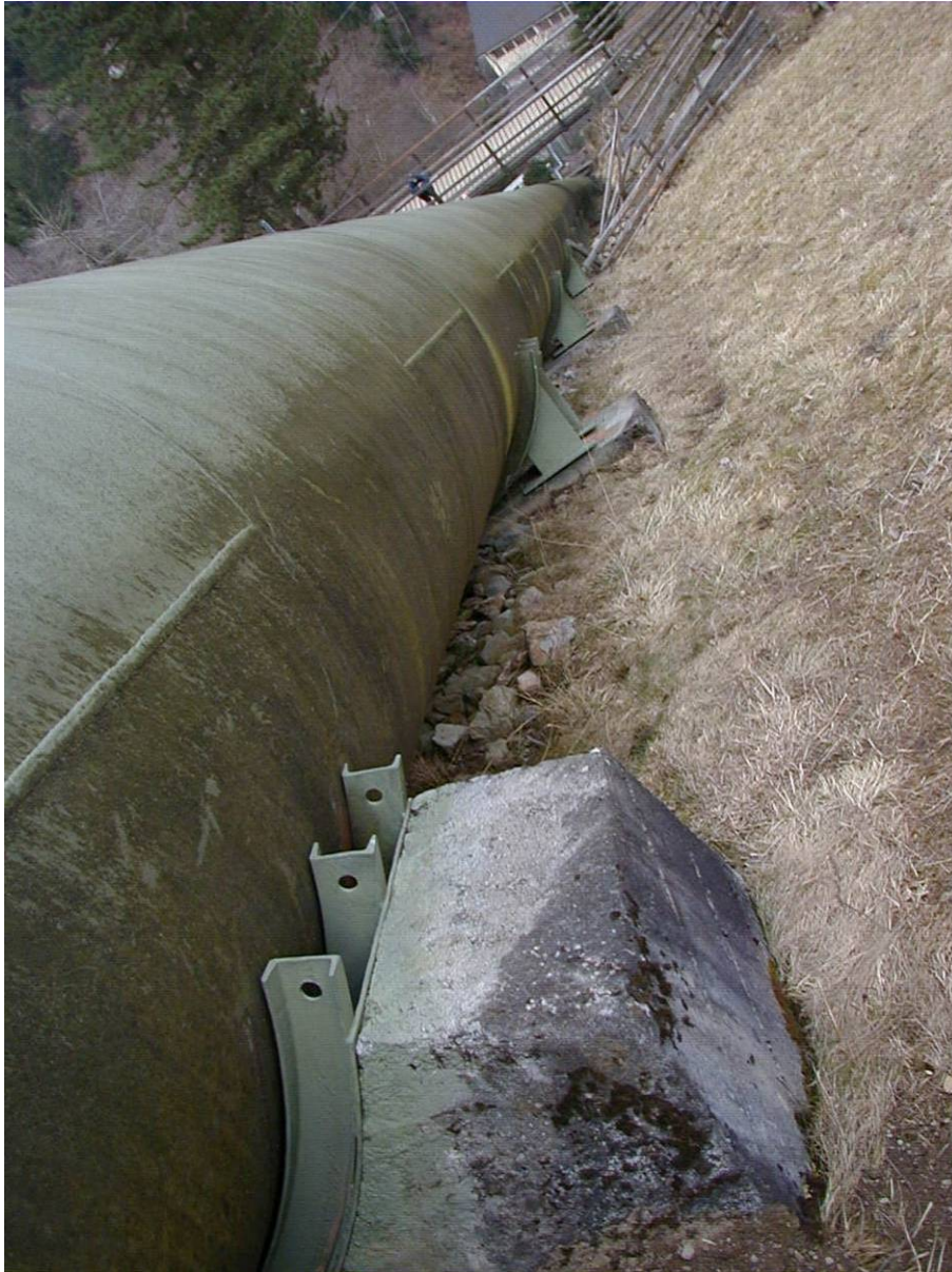
Foto 1 – vista della condotta forzata e delle selle d'appoggio da monte verso valle.
