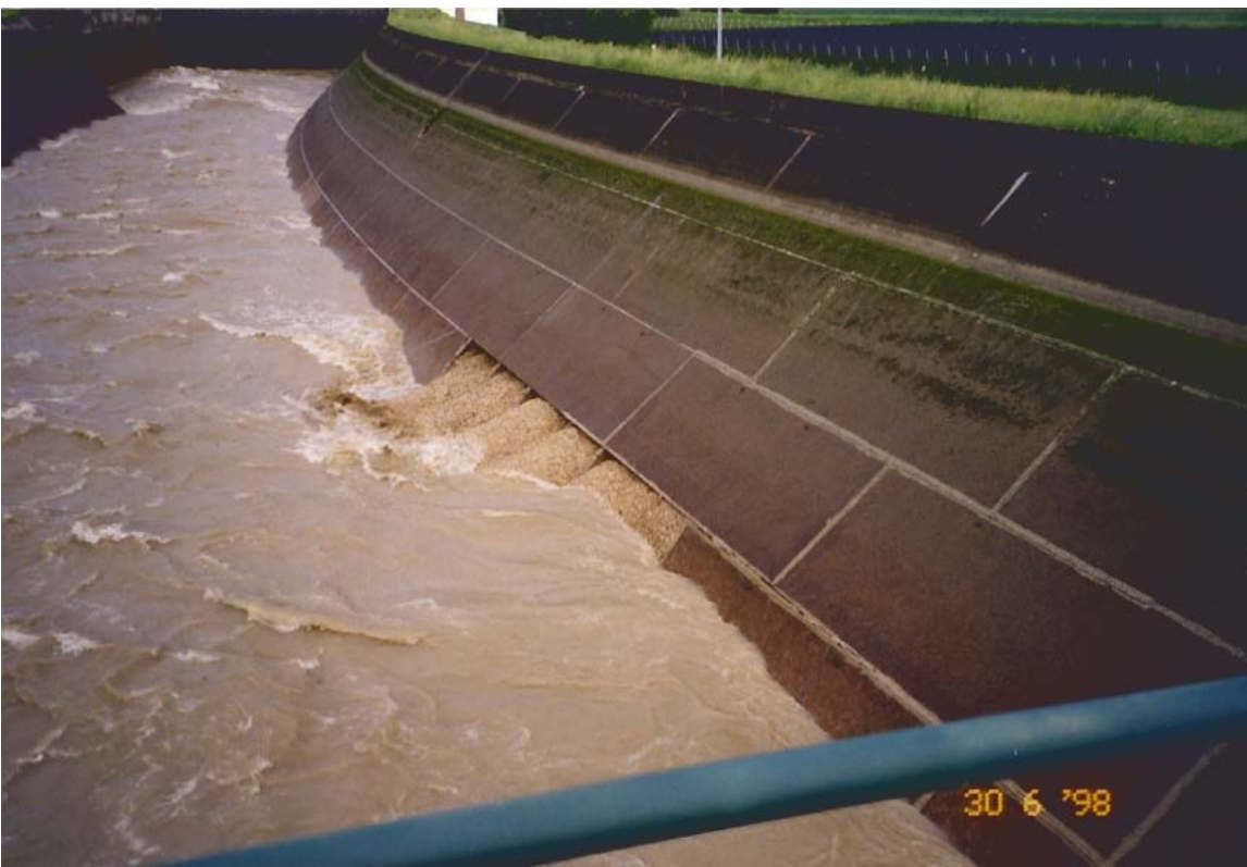
Foto 2 – distacco di una piastra del rivestimento di sponda e fuoriuscita del materiale drenante
