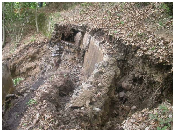
Fig. 16 – Rottura di un canale
