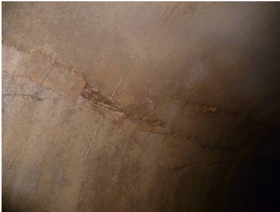
FOTO 3 – Fessure longitudinali in sinistra calotta con distacco vecchie sigillature e degrado del rivestimento
