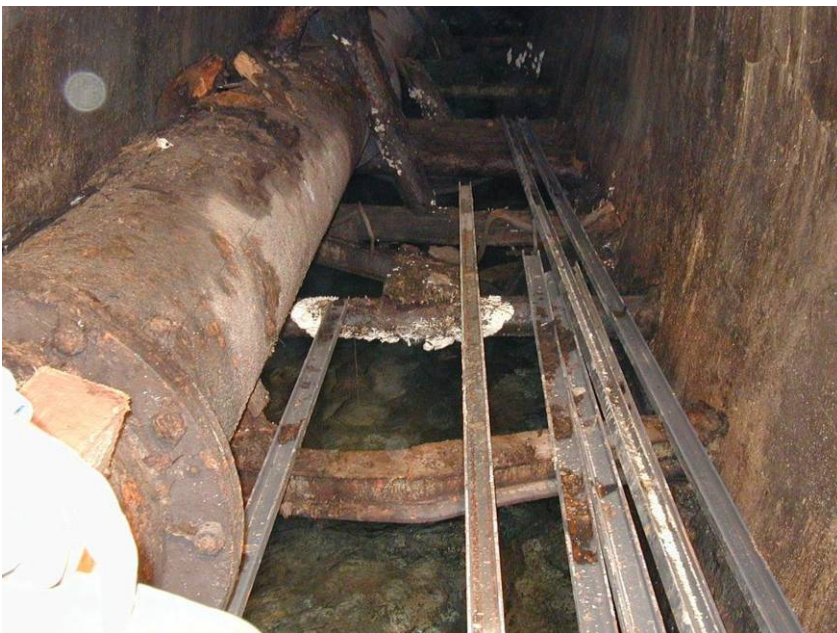
Foto 2 – Condotta di pompaggio \phi 500
