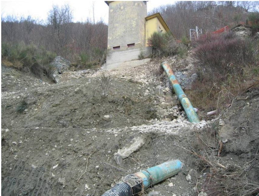
Foto 7 – Versante esterno e cabina di pompaggio, prima dell'intervento di stabilizzazione.
