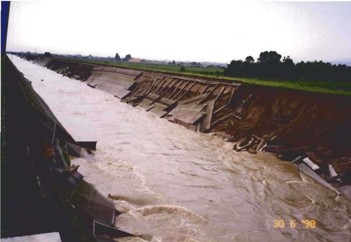
Foto 1 – danneggiamento del rivestimento di sponda in piastre prefabbricate
