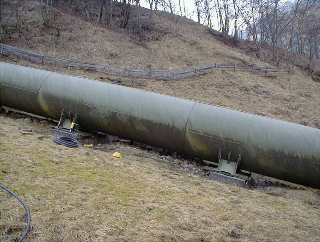
Foto 2 – vista scorrimento delle selle verso valle e piastre di appoggio allungate oltre la fondazione
