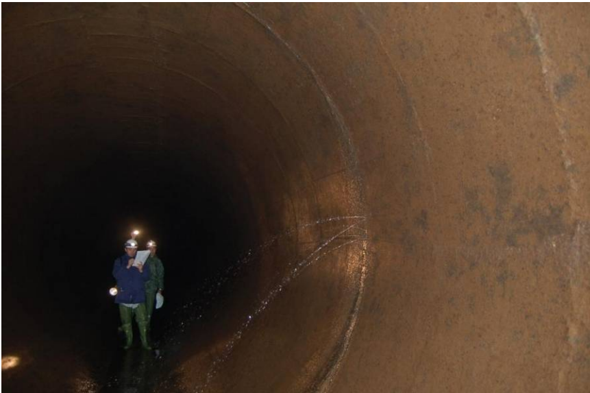
Foto 2 – Infiltrazioni d'acqua, in corrispondenza di lesioni anulari (principalmente nelle zone di ripresa di getti)
