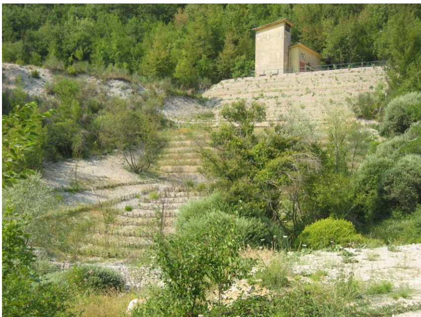
Foto 8 – Versante esterno e cabina di pompaggio, dopo l'intervento di stabilizzazione con opere in terre armate e di ingegneria naturalistica
