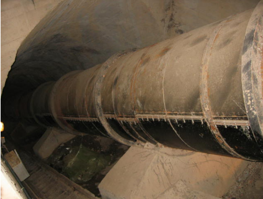
Foto 1 - Blindatura esterna del tratto ammalorato Intervento eseguito negli anni 90'
