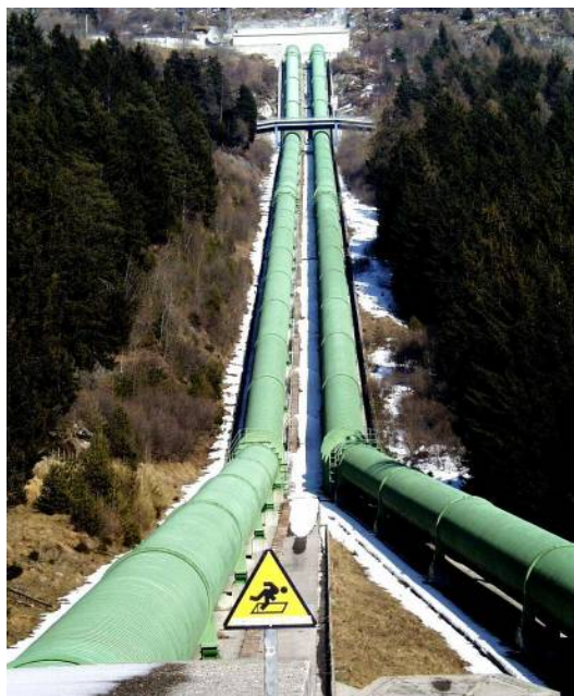
Fig.9 - Condotte forzate all'aperto
