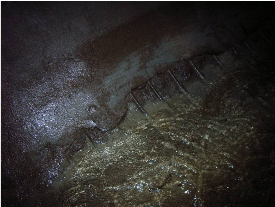
Foto 1 - Arco rovescio ammalorato, con distacco del copriferro ed esposizione delle armature.
