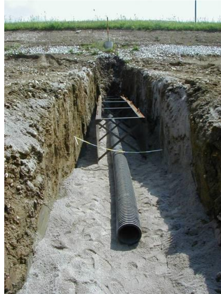
Rifacimento drenaggi trasversali (anno 2006); è visibile il tubo DN 200 ed il cassero per la realizzazione del filtro (internamente ghiaia ed esternamente sabbia)
