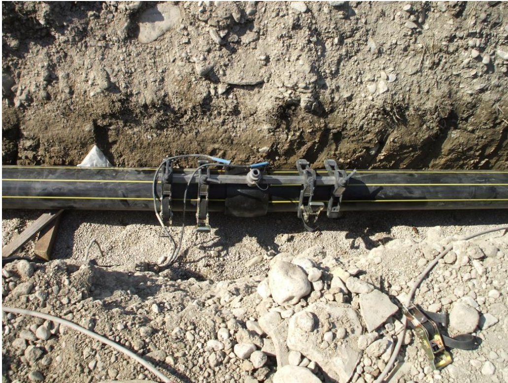
Condotta interrata DN 180 per l'alimentazione del bruciatore del forno a gas metano
