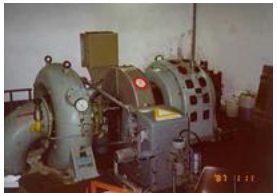
Ania (1901) Fluente – 0,4 MW 1,2 GWh/a
